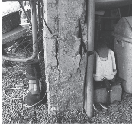
図14 基礎の鉄筋露出
