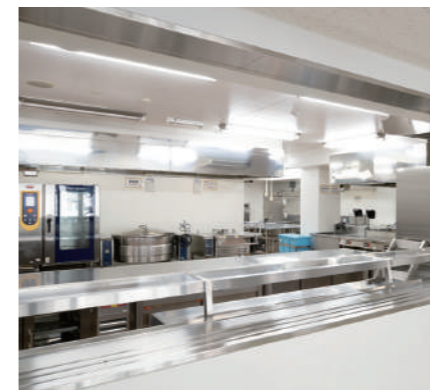
F 給食経営管理実習室 ドライシステムを導入した、オール電化の実習室。一度に150人分のご飯が炊ける炊飯器も完備。
